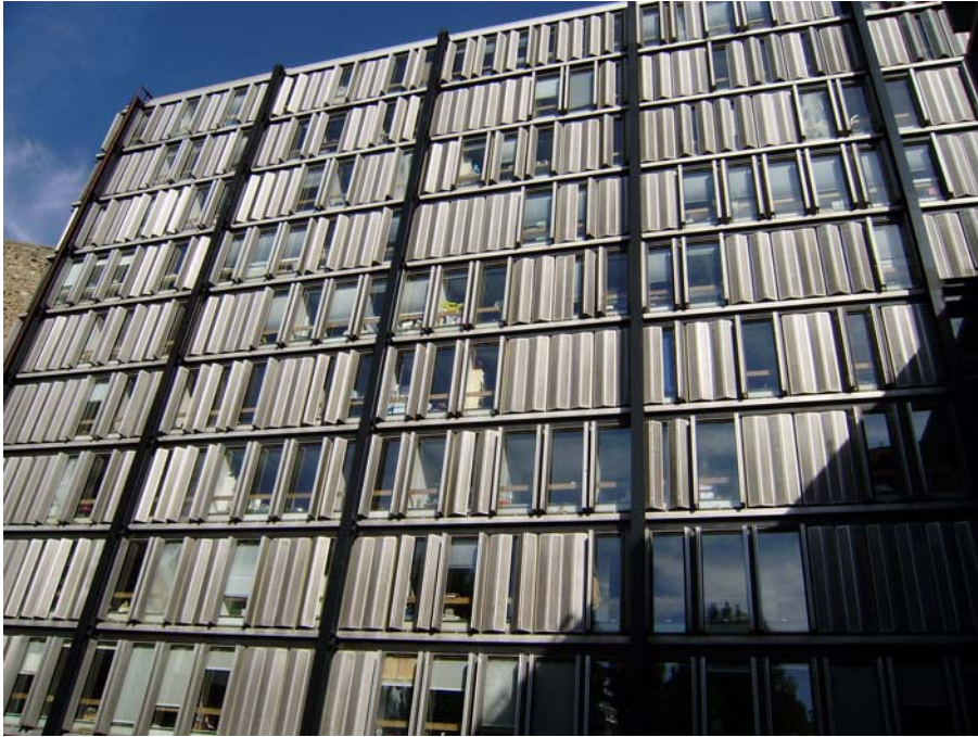
Edificio del 54 Boulevard Raspail. Se van a mudar en diciembre por que está viejo y con problemas de aluminosis.
